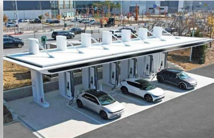
Tapak Khusus Untuk EVCB (forecourt)
